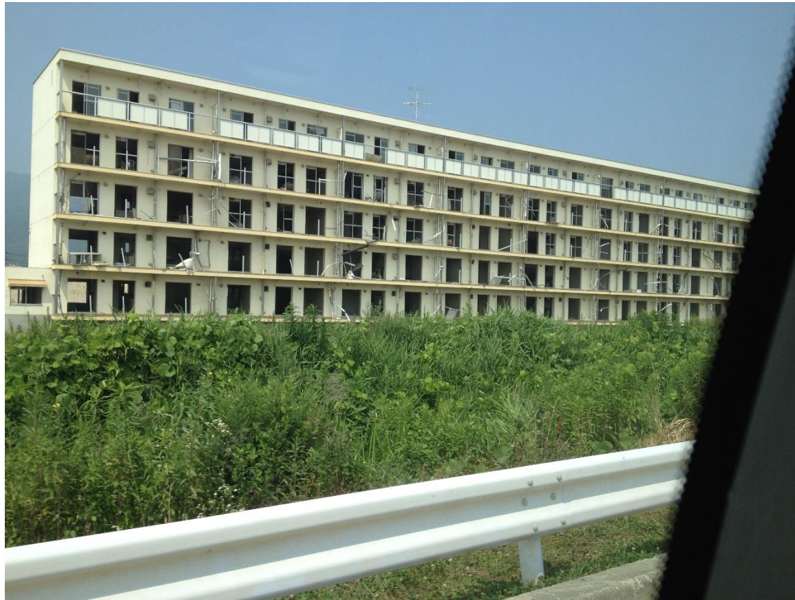
被災したマンション 4階と5階で被害の違いがある
